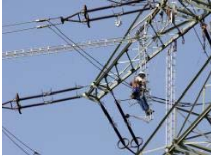
Hochspannungsmast: Viele Bürgermeister wollen die Versorgung von Strom, Gas und Wasser rekommunalisieren AP
